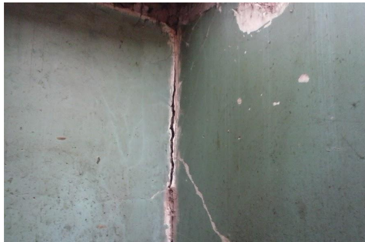
Figura 33: Fisuras en encuentro de muro de cocina y lavadero
