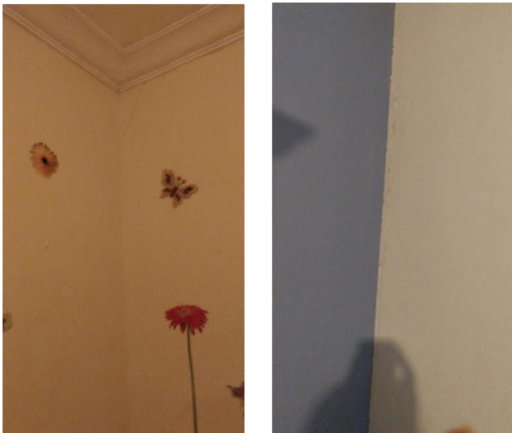
Figura 36: Fisura pasante en el encuentro de muros de dormitorio y estar comedor
