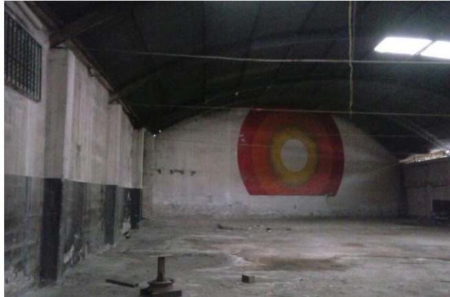
Figura 40: perdida de curvatura de los arcos y problemas de humedad
