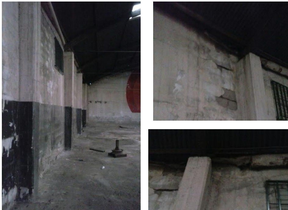
Figura 39: Pérdida de verticalidad y de revoque del muro este
