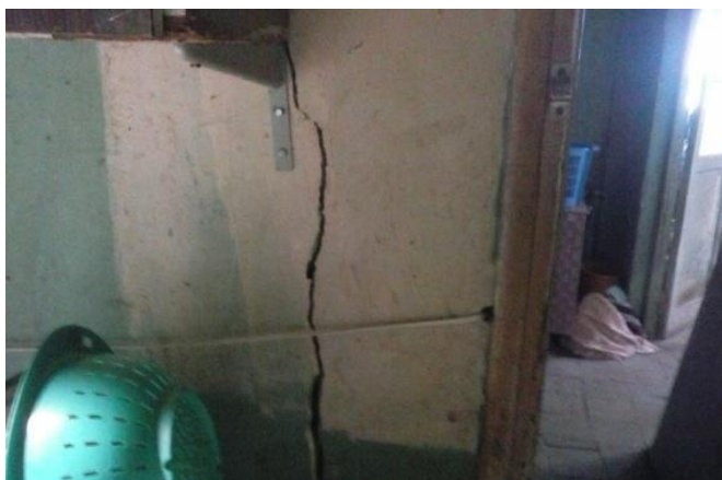
Figura 34: Fisura en muro de cocina
