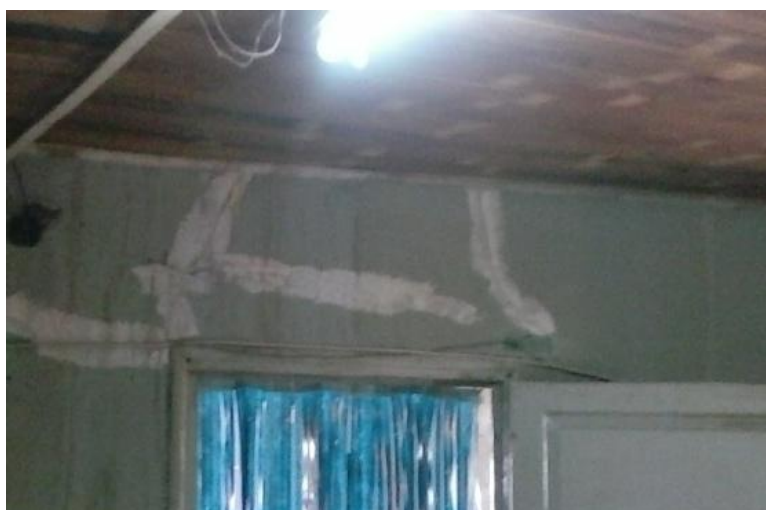
Figura 35: Fisura a la altura del dintel
