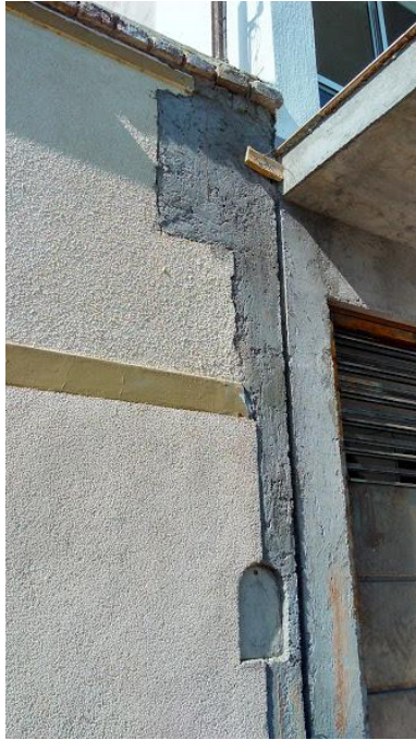
Figura 37: Desprendimiento de revoque parcial en fachada
