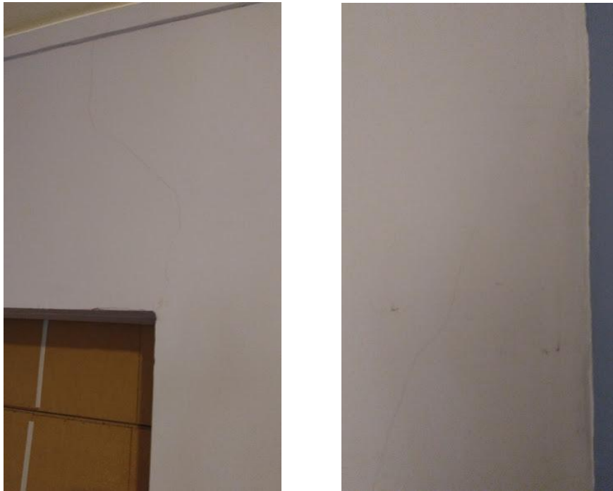
Figura 38: Fisuras varias en muros perpendiculares a la obra
