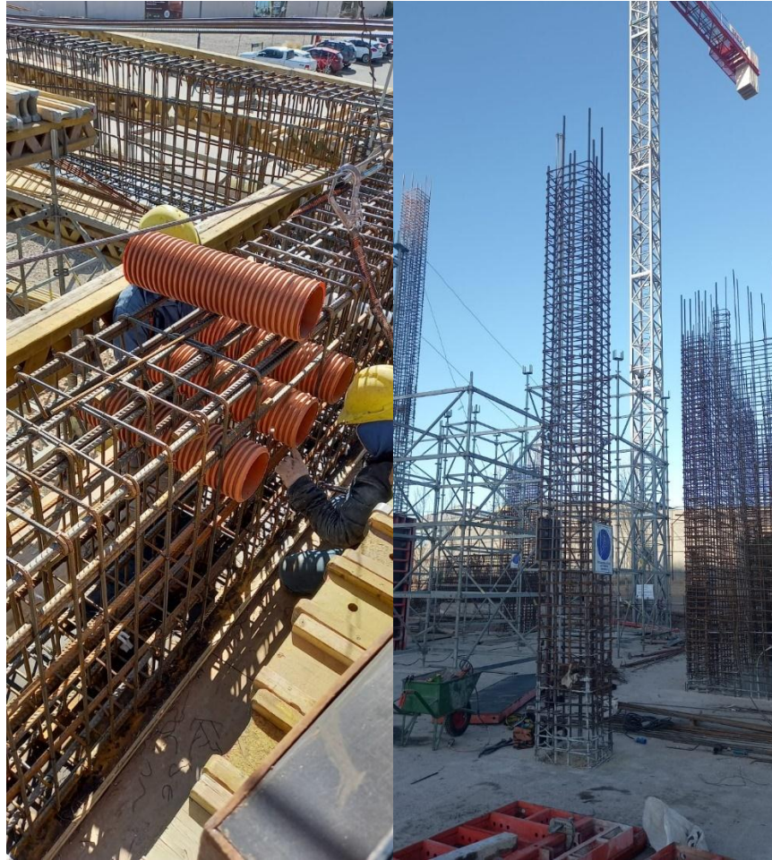
Fig. 41: Pases de instalaciones a través de vigas y armadura de columnas
