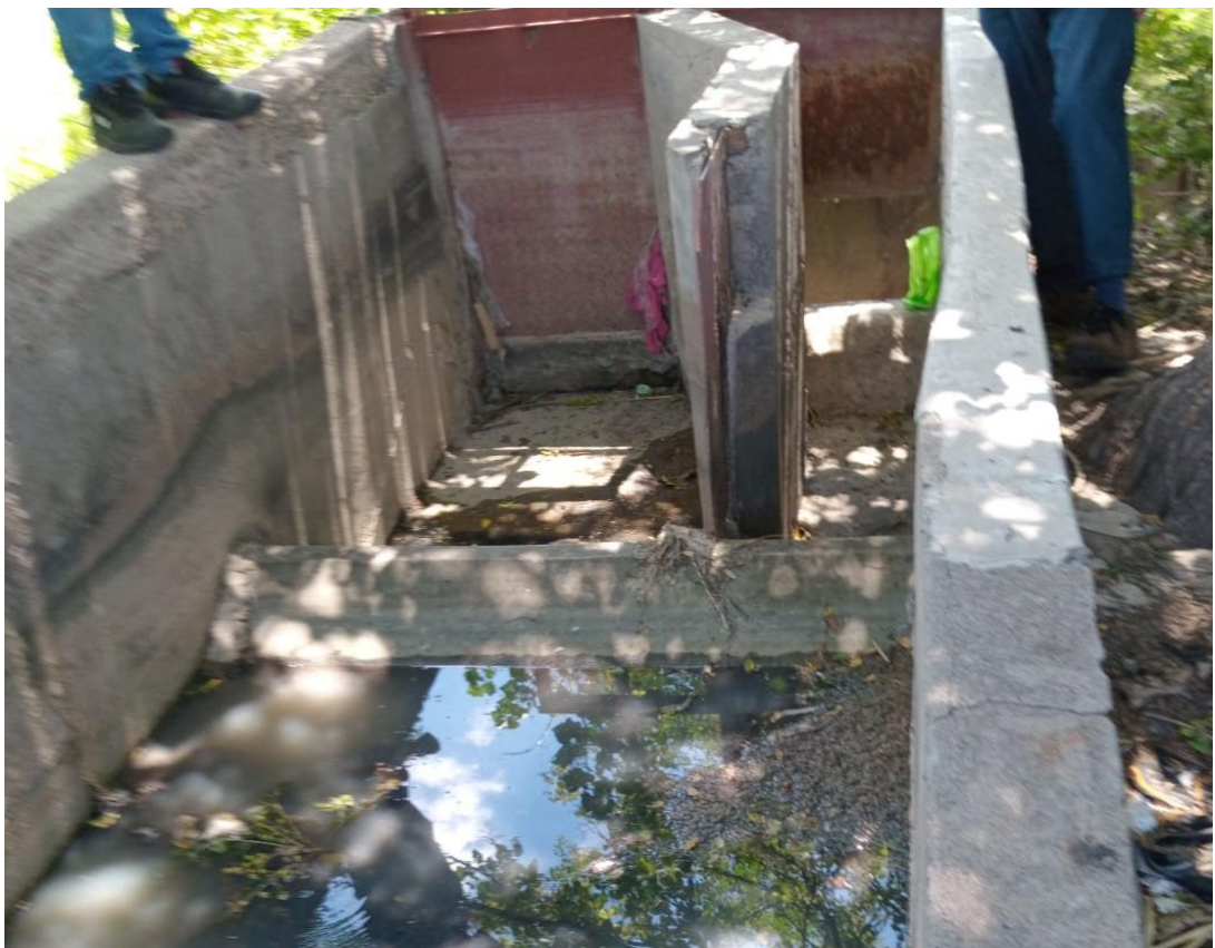
Figura 6. Vista del partidor fijo a reemplazar en el compartó Consorcio El Chañar
