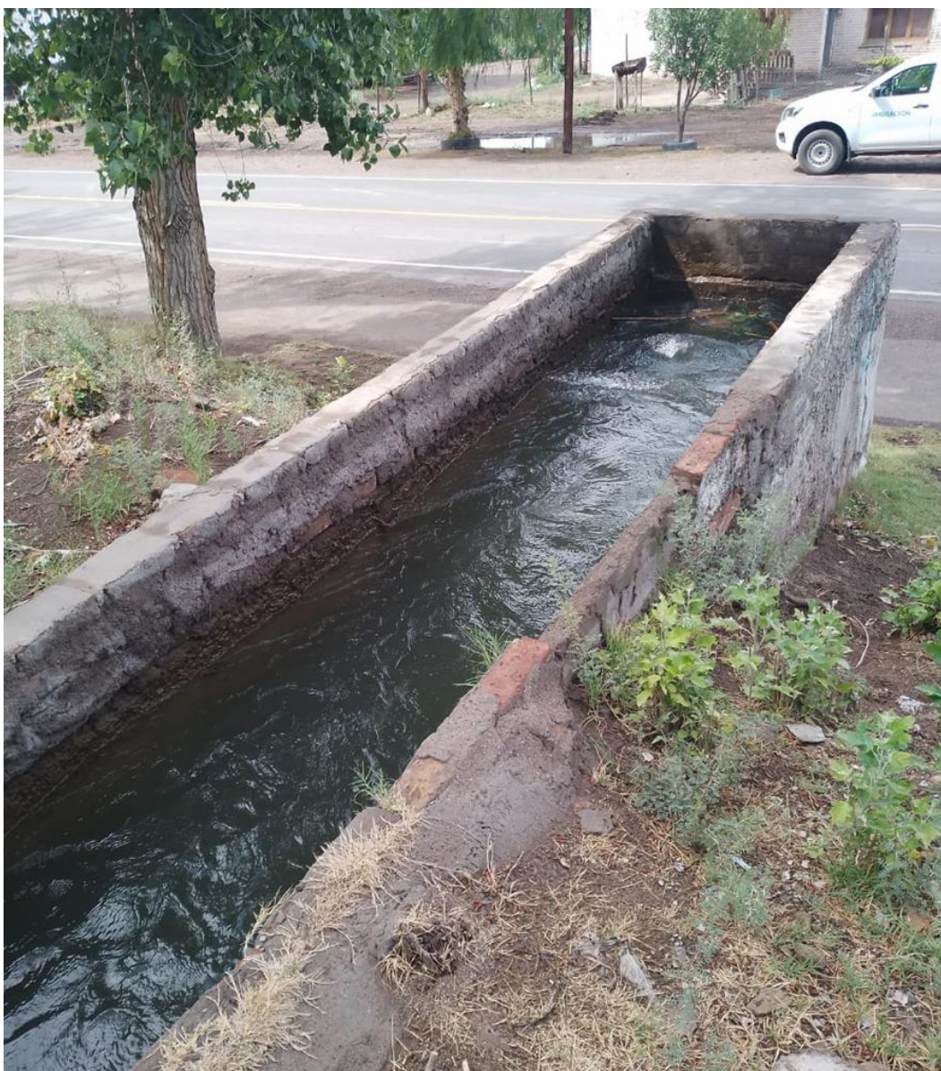
Figura 19. Ingreso del agua al sifón
