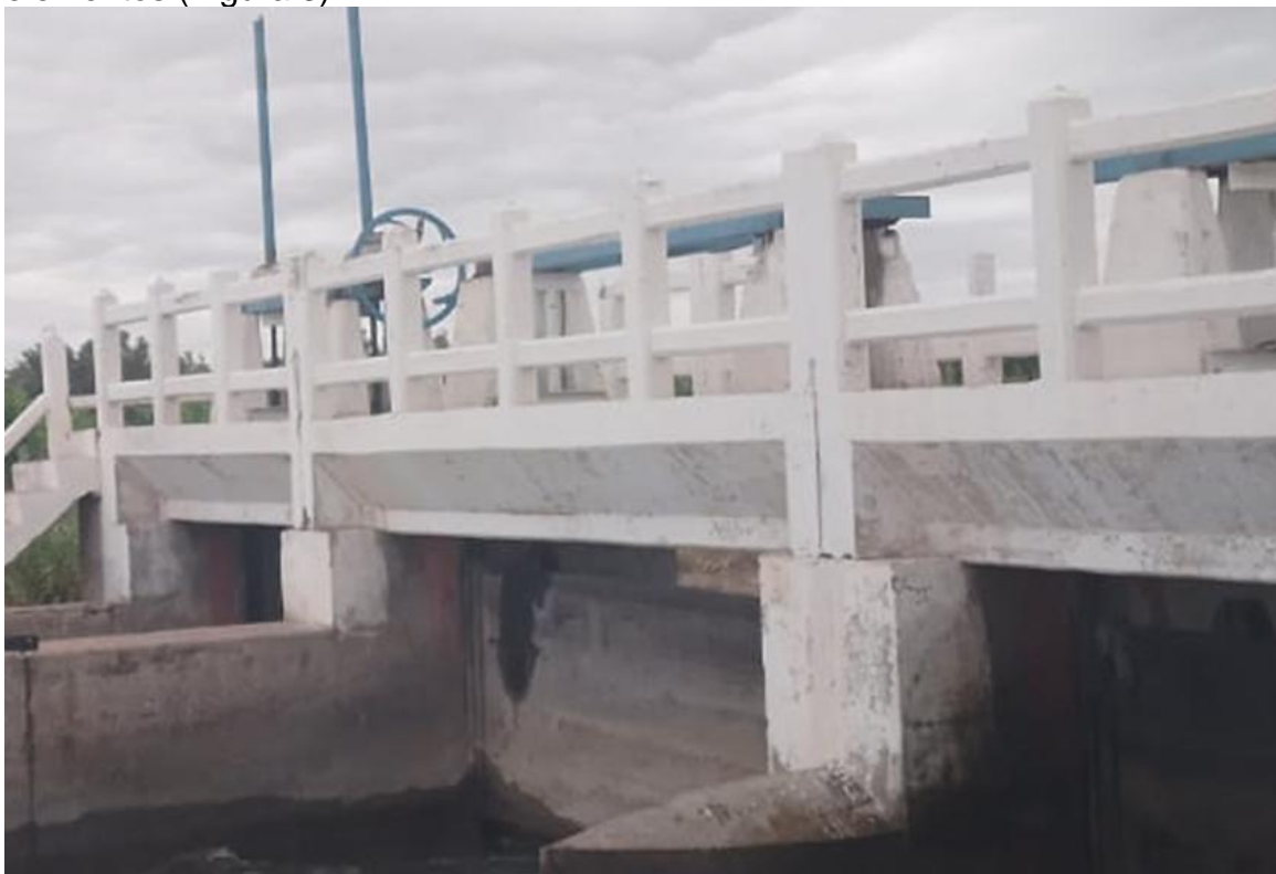
Figura 3. Compuerta en el canal Chacabuco
