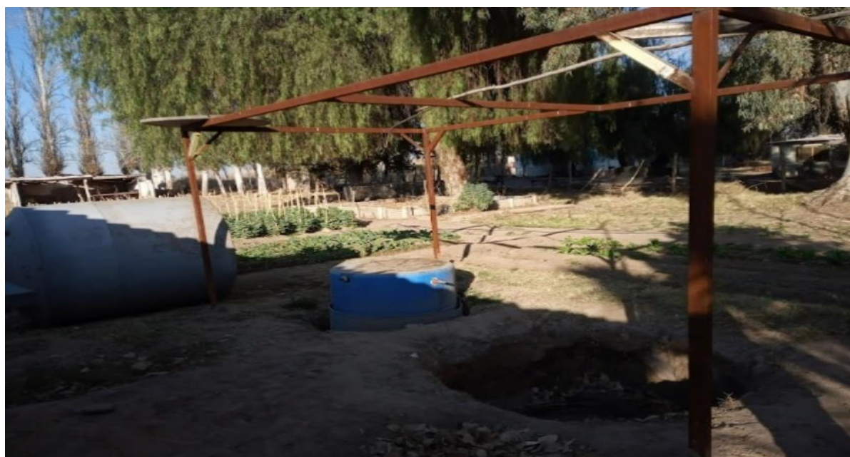
Figura N° 32: Estructura de sostén del colector solar y su acumulador. Fuente de elaboración propia, 2022.
