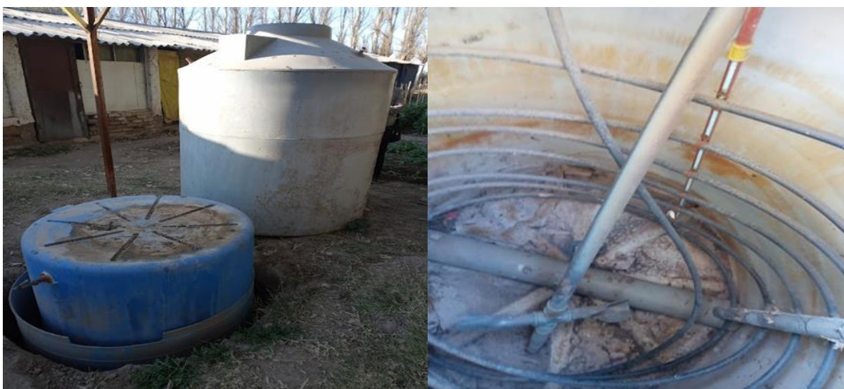
Figura N° 30 (Izquierda): Biodigestor (gris) con su gasómetro al costado(azul). Fuente elaboración propia, 2022.
