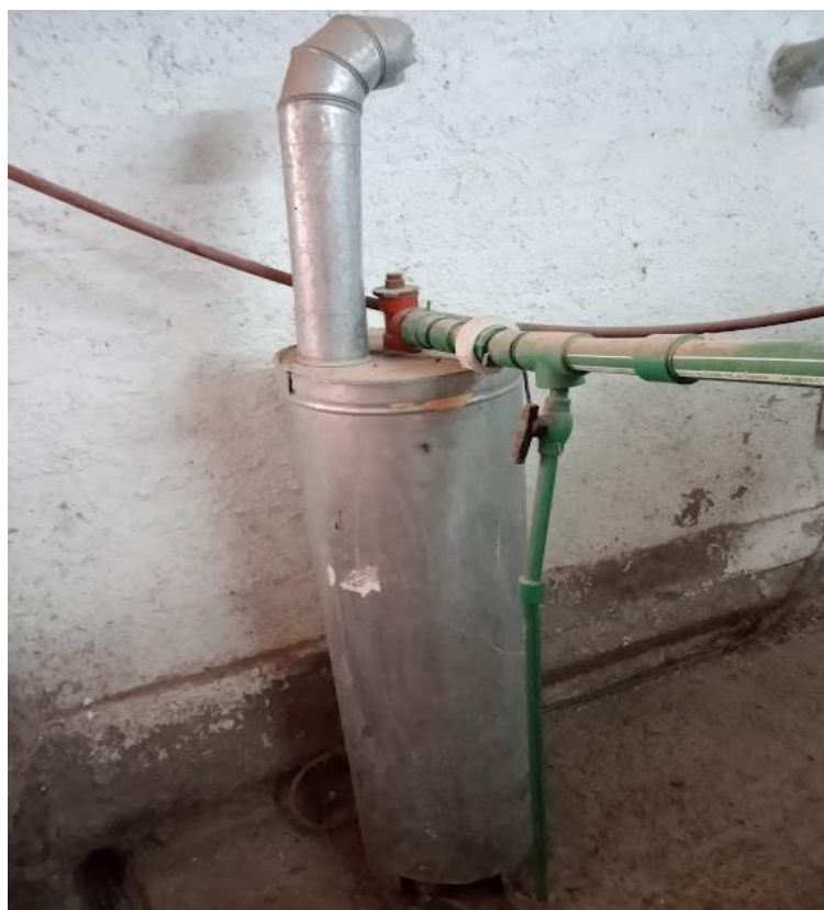
Figura N° 28: Caldera del Invernadero de la Granja Penal Gustavo André. Fuente de elaboración propia, 2022.
