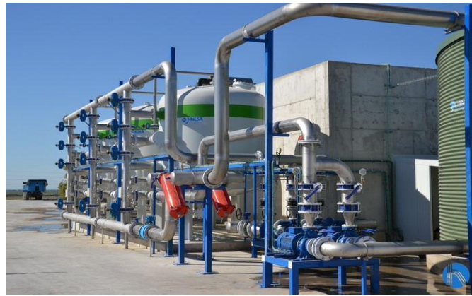
Figura 6.12. Sistema de filtración.
