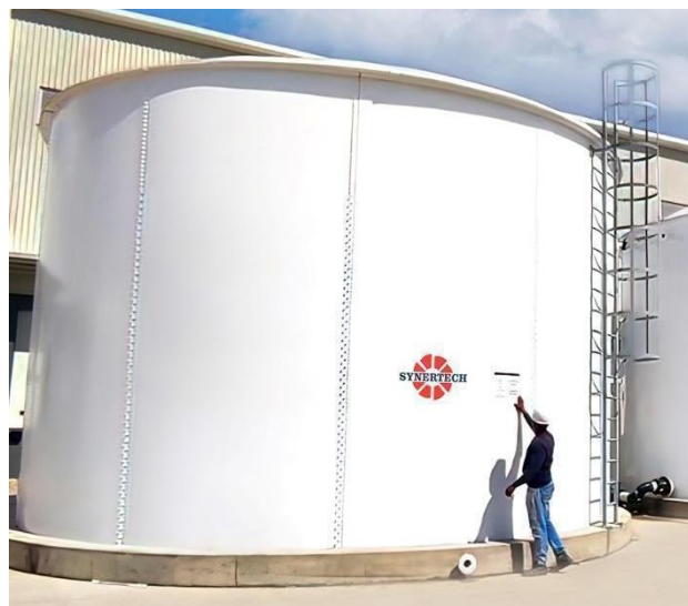
Figura 6.20. Ejemplo de tanque de almacenamiento de agua de la empresa Synertech.
